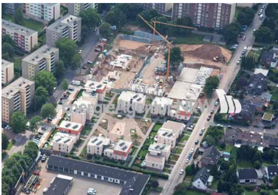
Der erste Baubabschnitt – im unteren Teil des Bildes zu sehen – ist bereits abgeschlossen.
